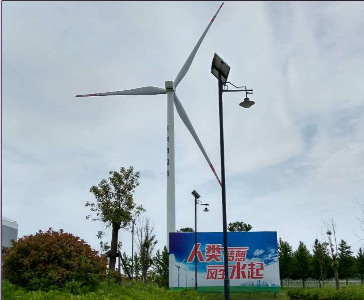
استغلال طاقة الرياح لتوليد الكهرباء بمحطة تحلية مياه البحر
